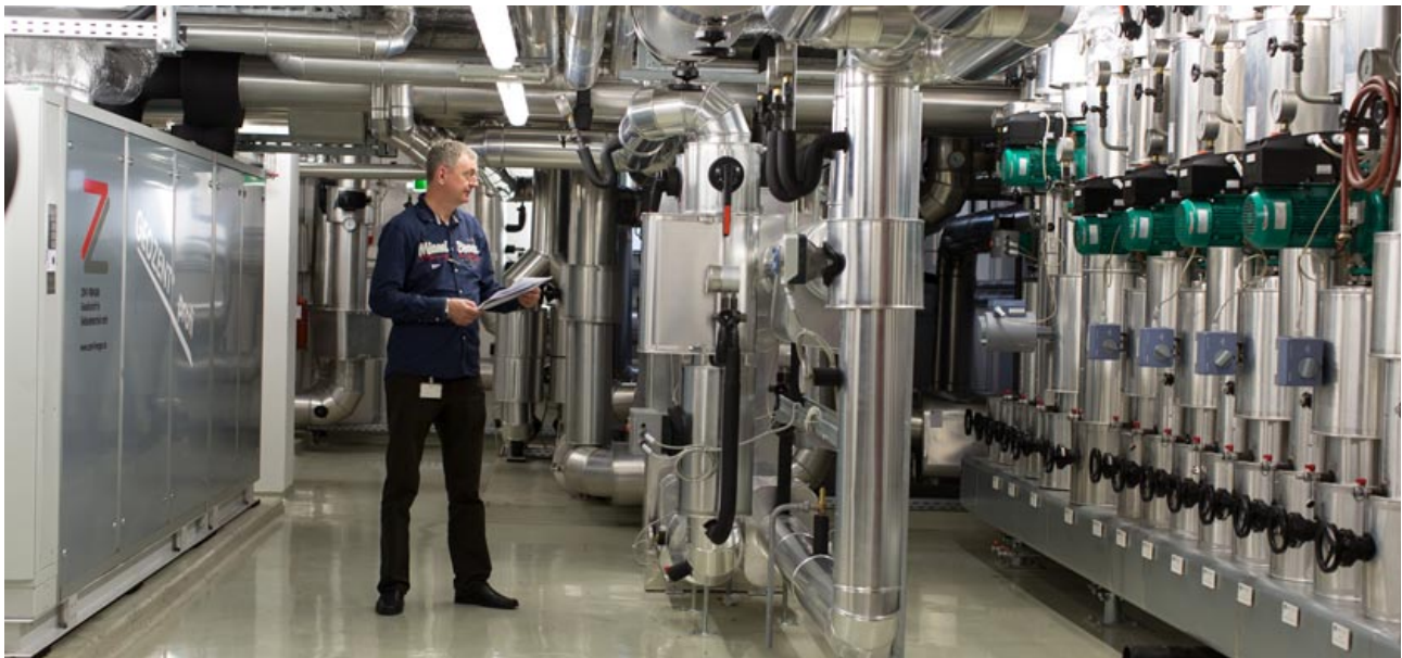
Die Geothermieanlage versorgt das Wiesbadener R+V-Bürogebäude mit Wärme und Kälte.
