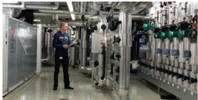
Die Geothermieanlage versorgt das Wiesbadener R+V-Bürogebäude mit Wärme und Kälte.
