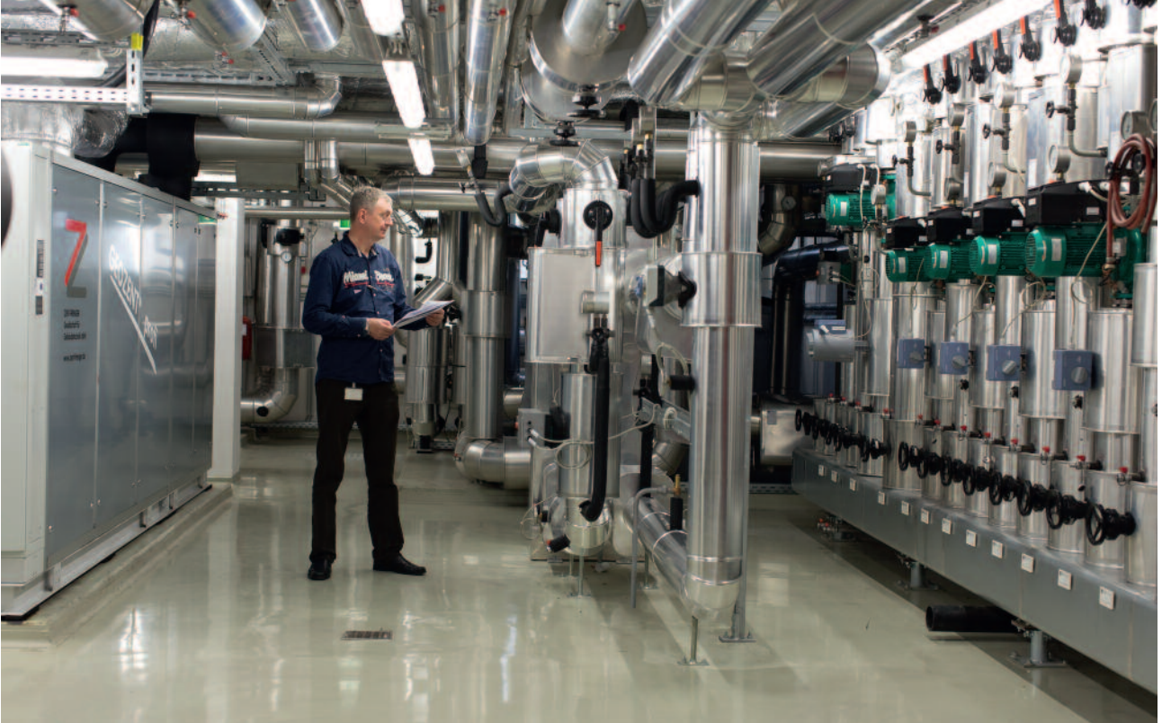
Die Geothermieanlage versorgt das Wiesbadener R+V-Bürogebäude mit Wärme und Kälte.
